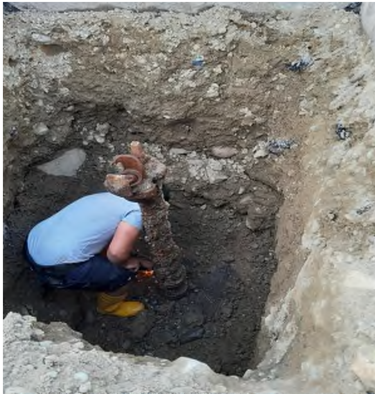
Defekter Hydrant getauscht
