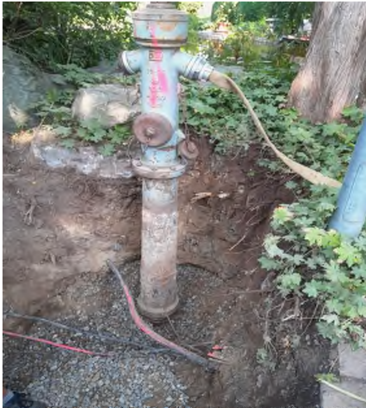
Defekter Hydrant getauscht
