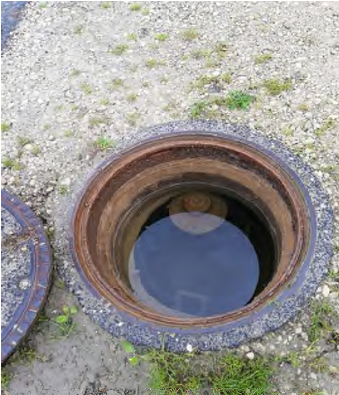
Wasser im Schacht
